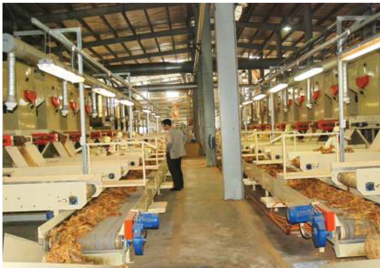
Dây chuyền chế biến nguyên liệu thuốc lá 24.000 tấn/năm của Công ty CP Ngân Sơn
